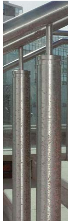
Roestvorming door ijzerdeeltjes op roestvast staal is geen mooi zicht. Het verwijderen ervan kan tijdrovend en duur zijn.
